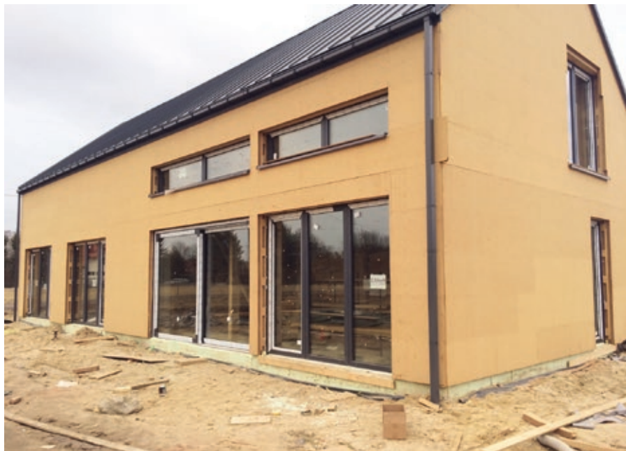
Fot. 22 Okna i drzwi balkonowe Adams Passiv-Line Ultra zainstalowane w budynku o szkieletowej konstrukcji drewnianej STEICO
